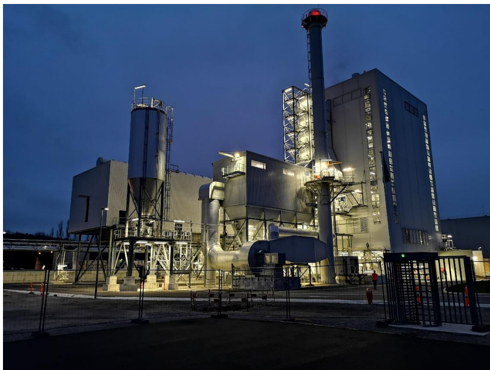
Cogénération Biomasse de Novillars.
